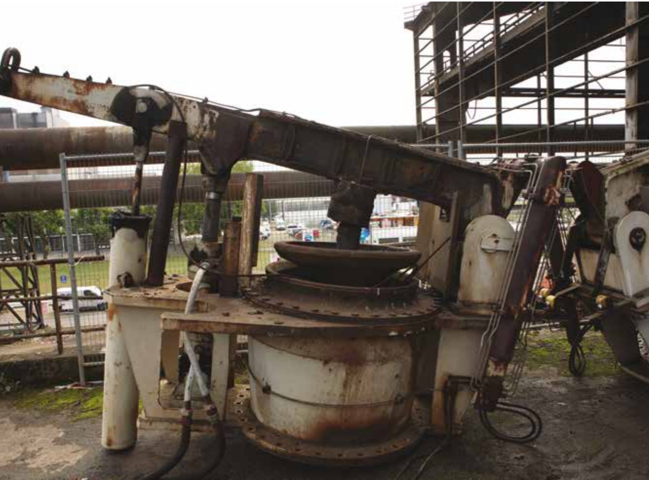
Les bleeders dans leur état corrodé, démontés en 2008-2009 et entreposés temporairement au niveau du plancher de coulée. Ici, ils sont détachés et séparés de leur plateforme de support.
