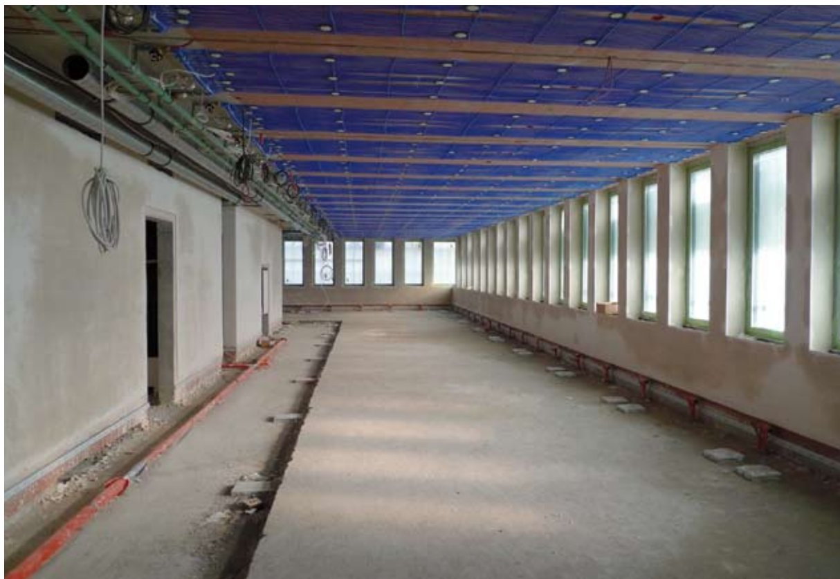
Plateau type de bureaux dans le bâtiment administratif - nattes capillaires de refroidissement dans le plafond
