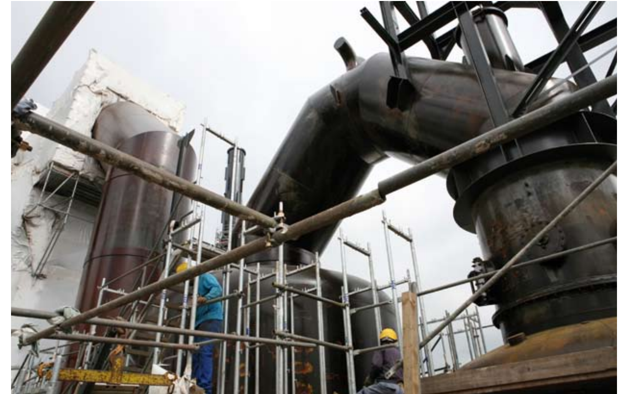
Le traitement de surface en cours sur l'épuration des gaz du haut fourneau B
