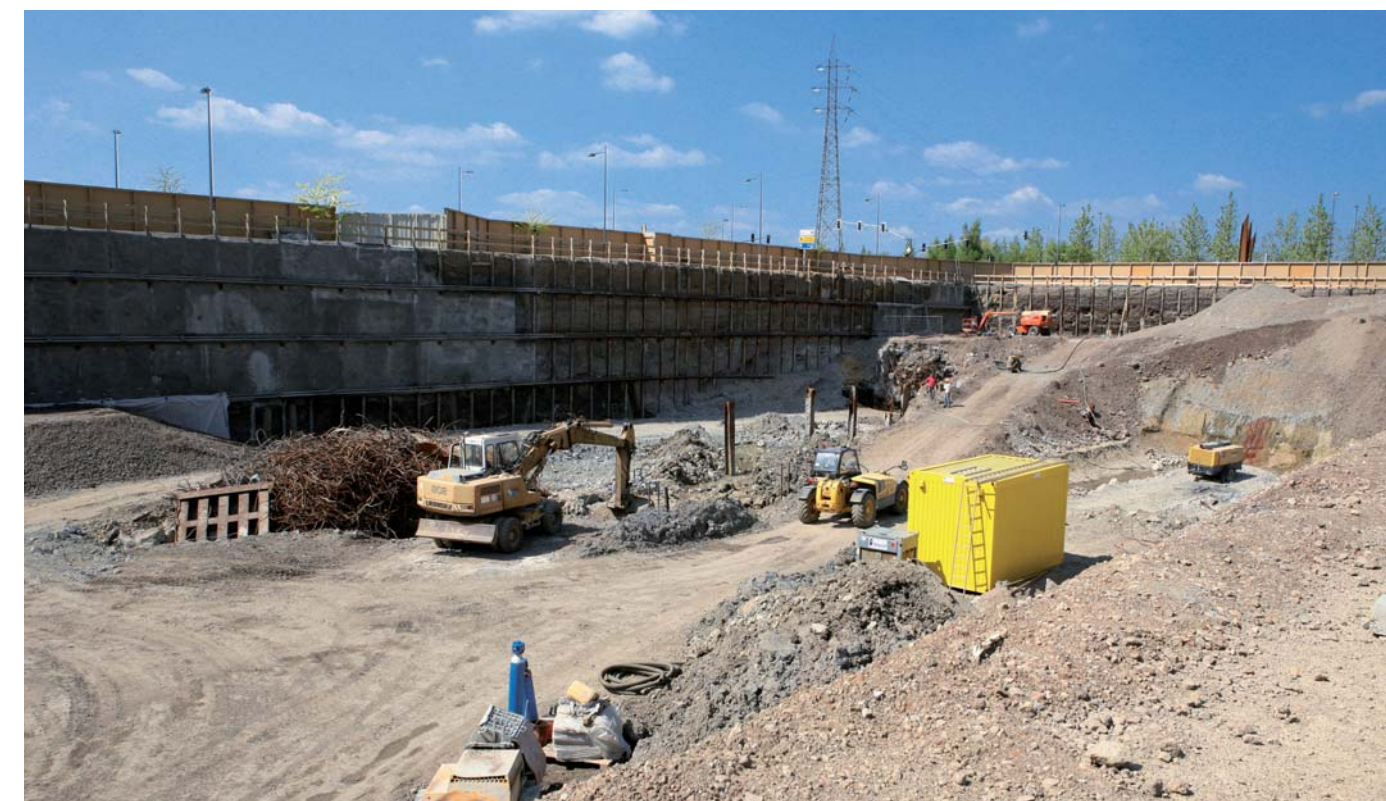
Les infrastructures industrielles dans le sol ont conditionné les préparations pour le chantier
