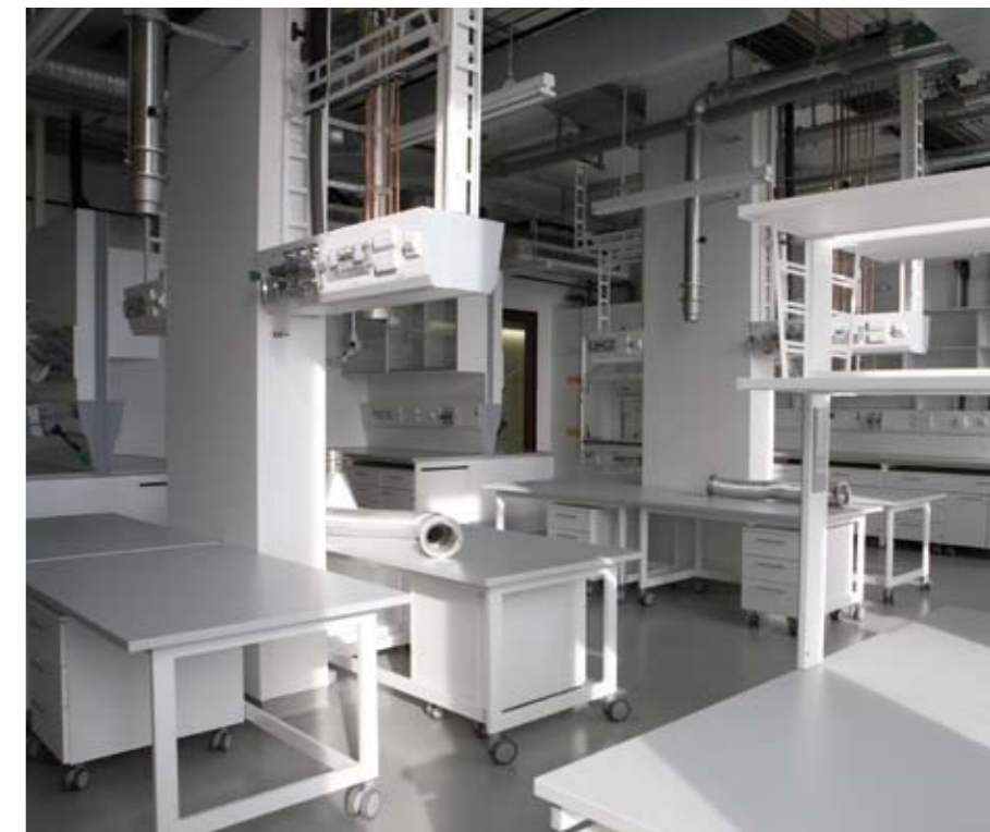
Équipement de laboratoire en cours d'installation
